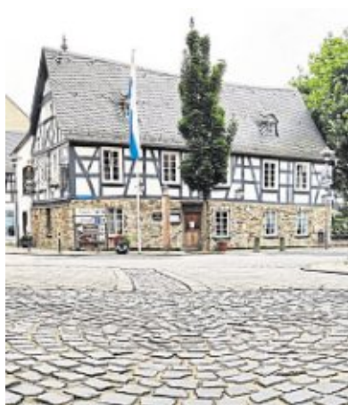
Schick sieht die gepflasterte Innenstadt von Höhr-Grenzhausen aus, aber die Mittelrinne muss saniert werden, um größere Schäden zu vermeiden. Foto: Quartiersmanagement
